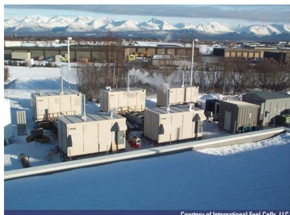
Rys. 8. Układ pięciu generatorów firmy International Fuel Cells zasilający rejonowy urząd poczty (USPS) w Anchorage, Alaska.
